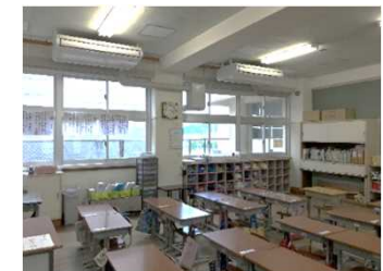
空調設備・換気設備を備えた教室
